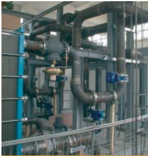
Seit Anfang Februar erfolgt die technologische Ausrüstung der neuen 30 MW Station
